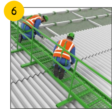
Wir betreten nur durchtrittsaichere Dächer und Bauteile.
